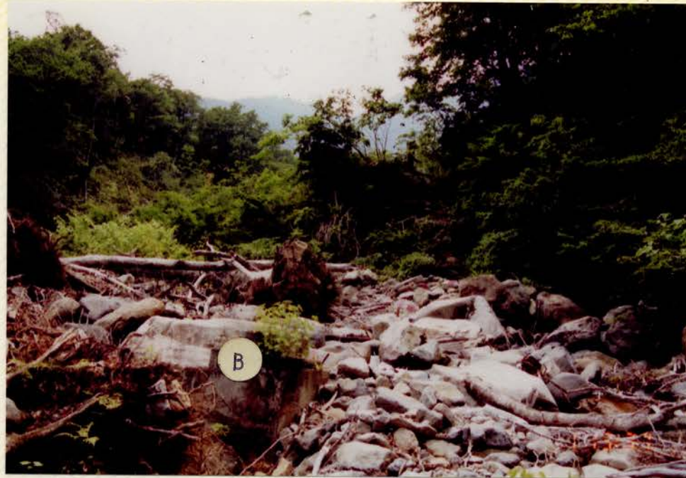
流された橋の右岸の橋脚(B)、01/6/16
