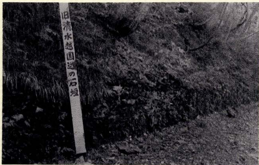
旧道の石垣、1981/10/10-11 この写真は一の倉沢-巖ノ沢間のもの
